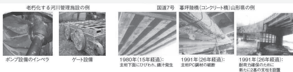
図表 151 老朽化する施設
